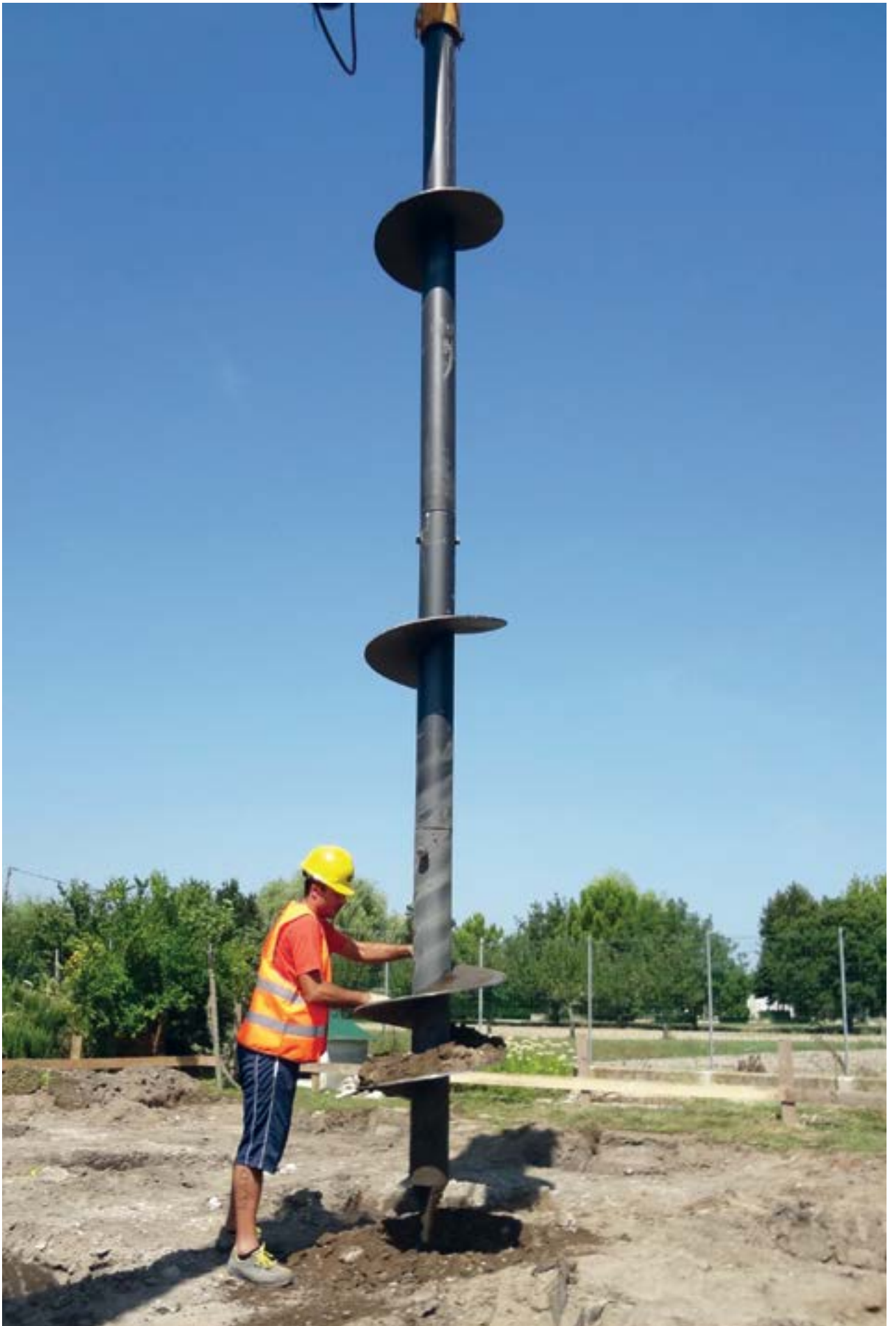
Paio Geopal® ad alta capacità portante PVD 168 utilizzato in un cantiere a Chioggia (VE).
