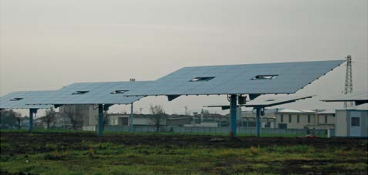
Impianto fotovoltaico su tracker ancorato al suolo con pali a vite Geopal® PVD.
