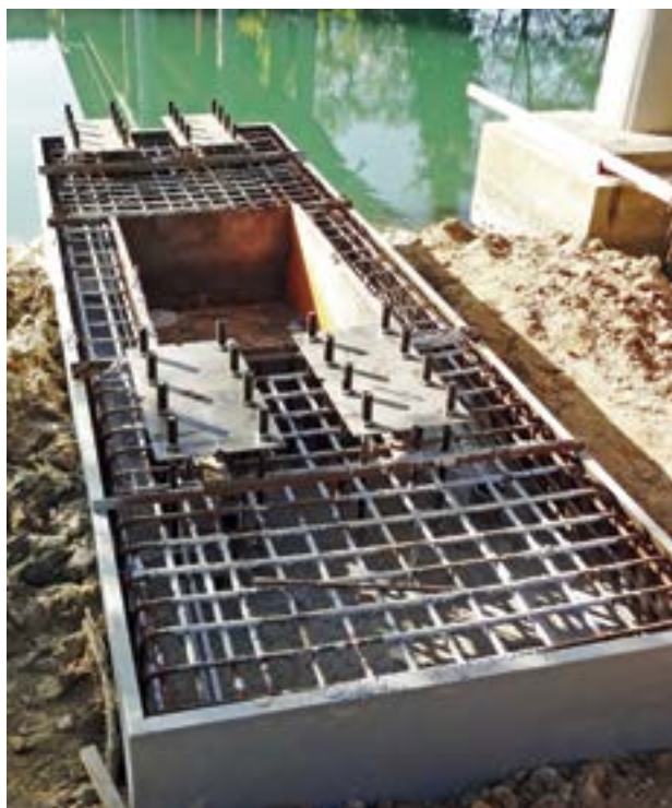
Particolare del basamento fondazionale di contenimento teste dei pali fondazionali Geopal® mod. PVD impiegati per il sostegno del ponte.
