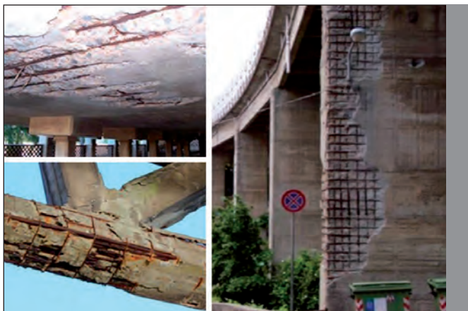
Figura 96. Corrosione dell'armatura metallica di elementi strutturali in c.a..
